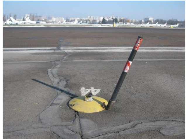
Рис. 6. Фото основи кріплення зруйнованого бічного вогню ЗПС № 44
