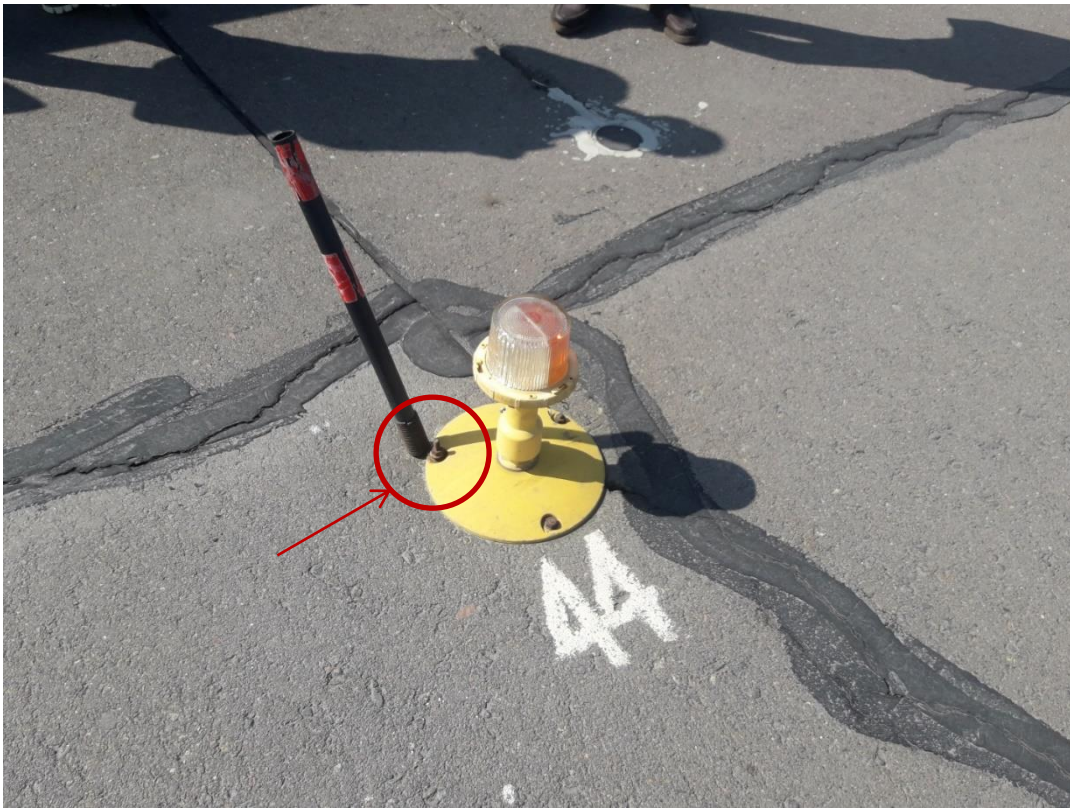
Рис. 7. Фото відновленого бічного вогню ЗПС № 44
