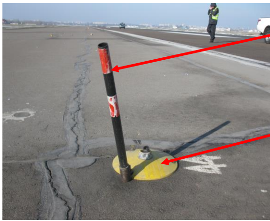
Рис. 3. Зруйнований вогонь ЗПС № 44.
