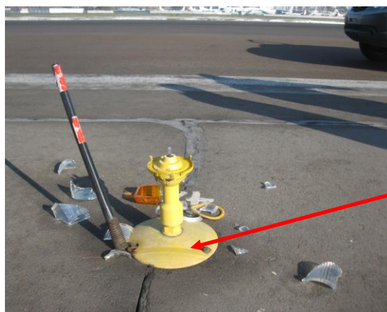
Рис. 3. Зруйнований вогонь ЗПС № 42.
