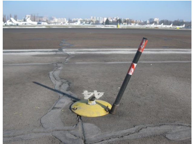
Рис. 6. Фото основи кріплення зруйнованого бічного вогню ЗПС № 44
