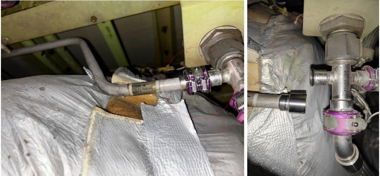
Мал.5. З'єднувальна муфта (Clamshell) трубопроводу подачі води
